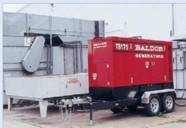
Для каждого из трех 100-тонных кондиционеров воздуха на нашем заводе в Уэствилле, Оклахома, были установлены 140-кВт (175-кВА) прицепные дизель-генераторы. Это позволило сократить пиковую нагрузку сети приблизительно на 450 кВт.
